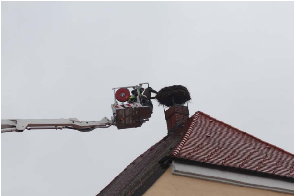
Horstsicherung (© Marion Schindlauer)
